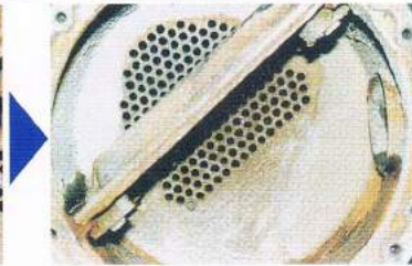
設置後6ヶ月、スケールと錆が取り、機能が回復。
