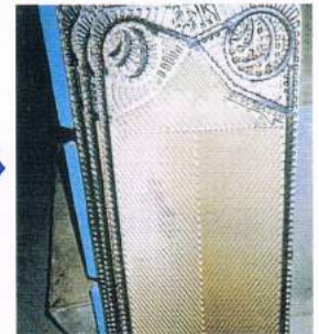
温泉水の入口側は設置されていて、赤錆は付着していない。
