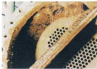
設置前、チラーのカバーにスケールと錆が目立つ。
