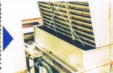
設置後3ヶ月、フォイルのスケールが完全に取れている。
